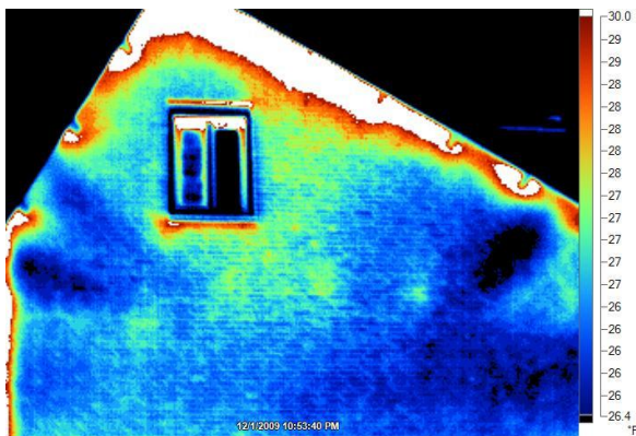
figuur 6.1 infrarood foto van een zijgevel met warmtelekken
